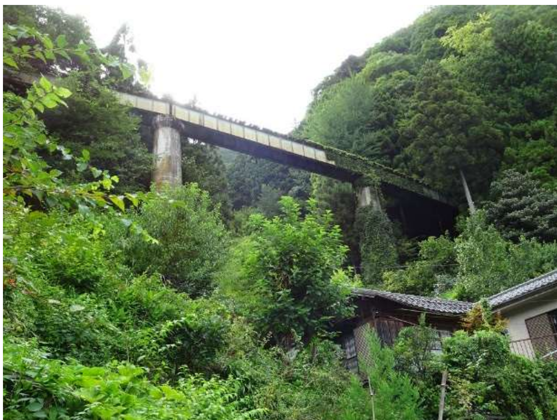
境集落にて高い位置に巨大なガーター橋の第四境橋梁 部品の破損も見られ、崩壊の懸念も
