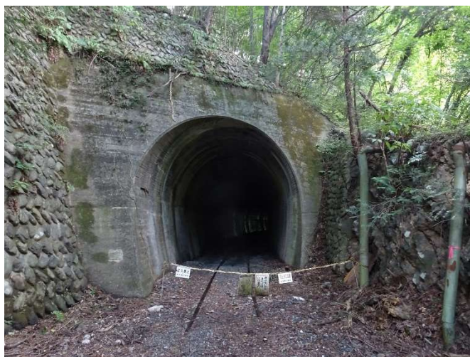
第三氷川トンネル 氷川側 立入禁止のロープと表示
